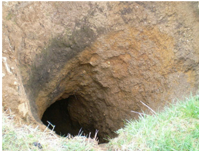
Bild 1: Erdfall bei „Am Siebenkreuz“ (7032/D063, K68) (Foto E. Klann vom 17.04.2009)
